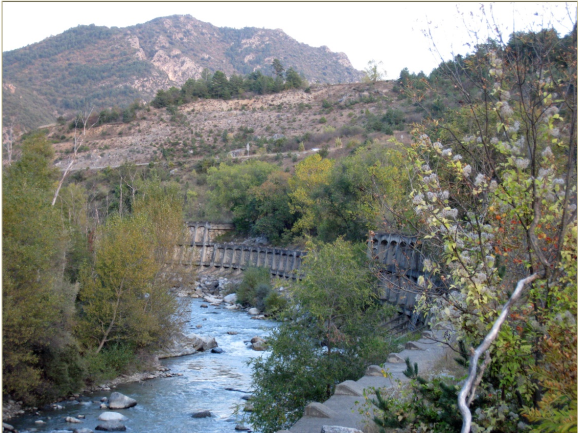
Mauer am Hangfuß zur Stabilisierung einer großräumigen Rutschung.
